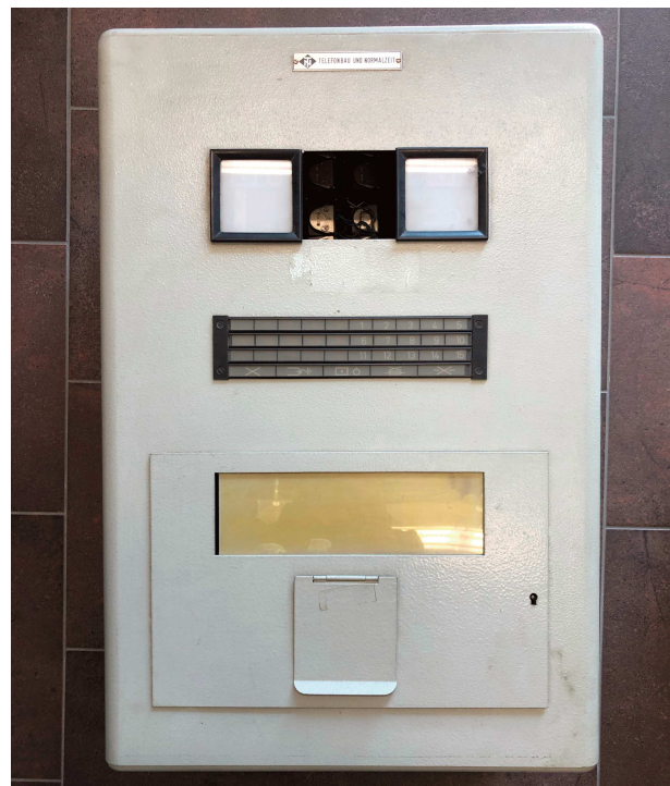
Abb. 18: Brandmeldeanlage aus den 1960ern
