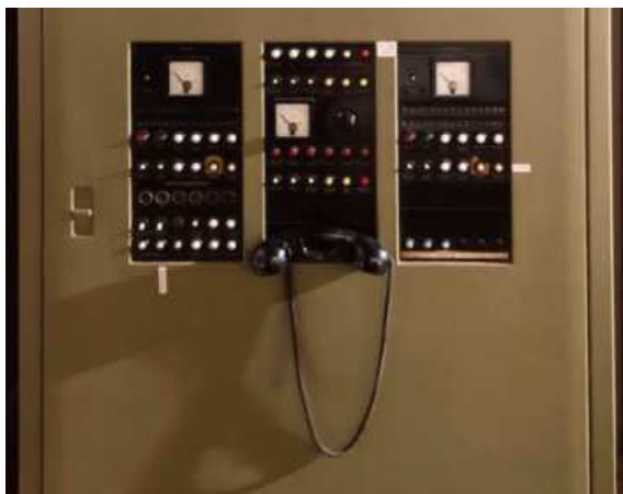
Abb. 13: Bedienfeld der Feuermelderempfangseinrichtung wie sie in ähnlicher Form 1967 bei der Feuerwehr Biberach eingesetzt wurde (Feuerwehrmuseum Ravensburg)
