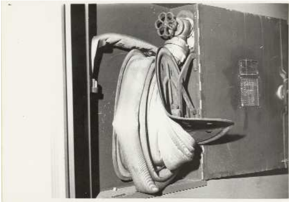
Bei einem Hochhausbrand bekamen die Angriffstrupps kein Wasser, weil die Ventile der Strahlrohranschlüsse geöffnet waren.
