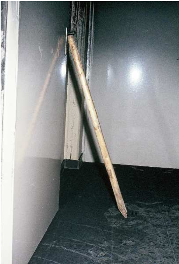
Immer der gleiche Fehler aus Bequemlichkeit. Die Brandschutztüre zur Tiefgarage wurde mit einem Pflocken festgestellt. Als ein Fahrzeug in der Tiefgarage brannte war im Nu der Treppenraum unbeherrschbar und die Bewohner mussten mit Drehleitern gerettet werden.
