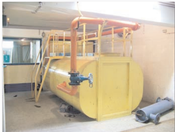
Übungsanlage für die Ausbildung von Atemschutzgeräteträgern
